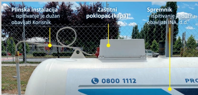
Slika 1. Mali spremnik za UNP s plinskom instalacijom
